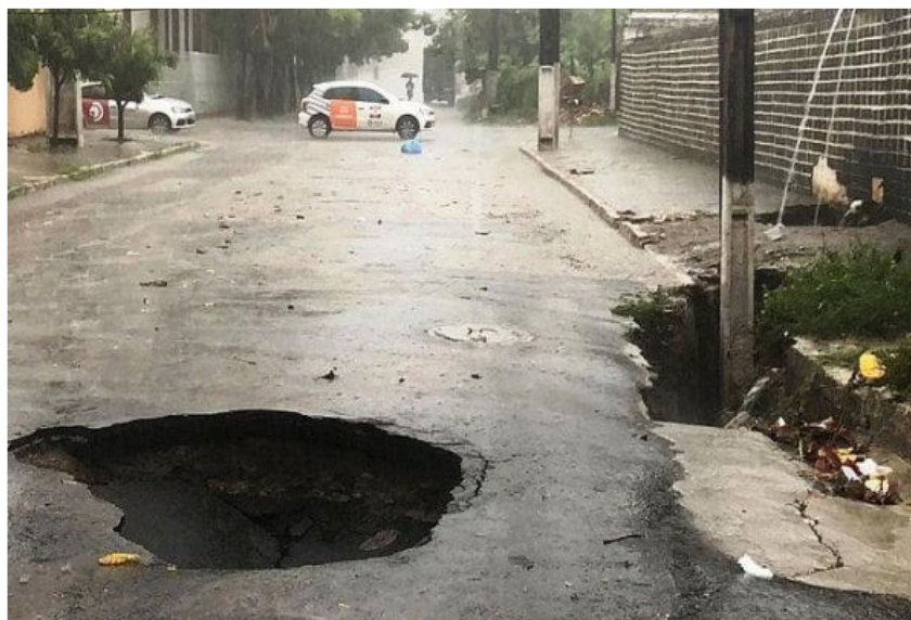
Figura 29 - Situação atual do bairro do Pinheiro em Maceió - AL.
