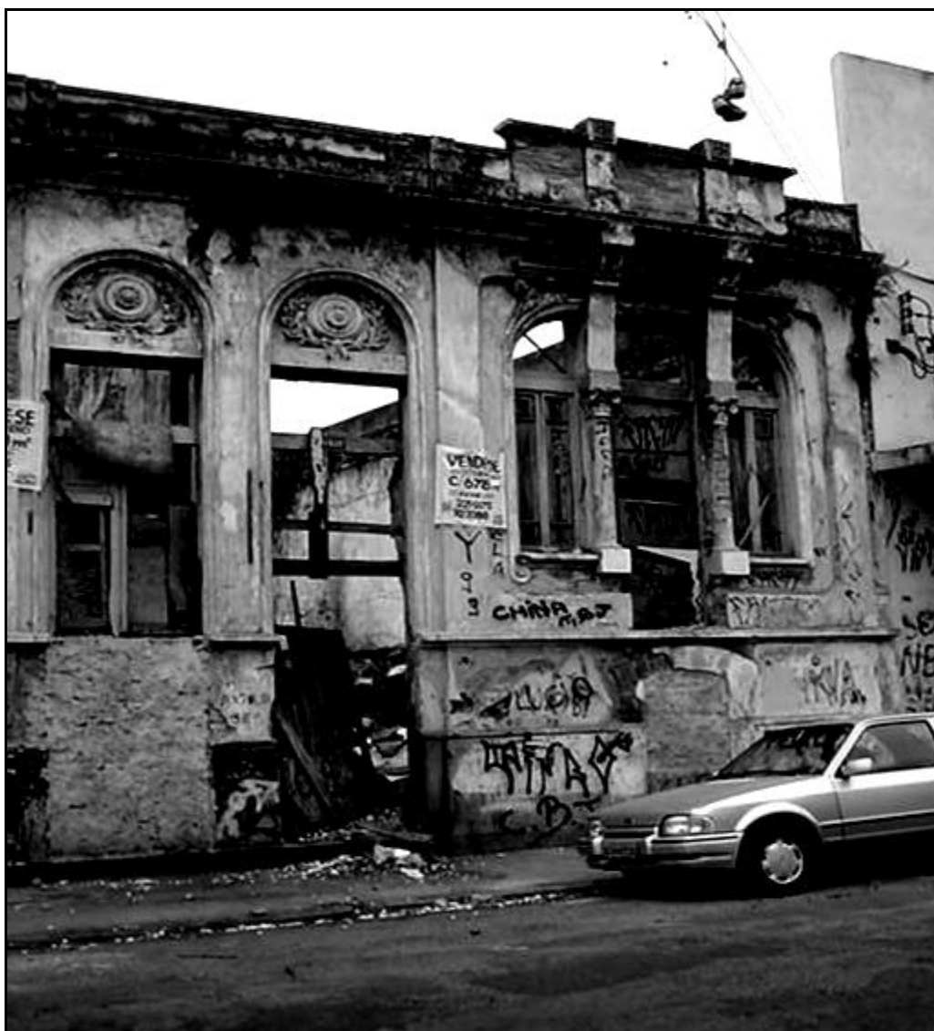
Figura 18 - Imóvel deteriorado no bairro do Paquetá (SEPLAN, 2003).
